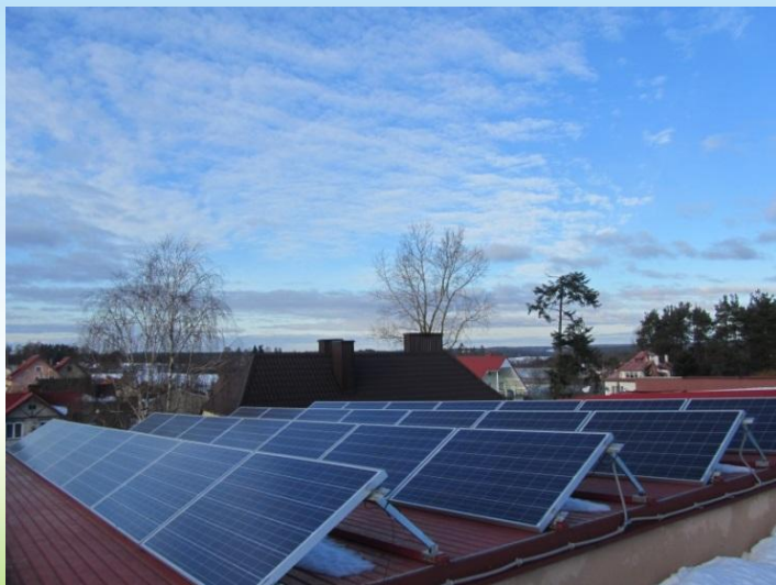
Panele fotowoltaiczne na dachach szkół w gminie Czarna Dąbrówka - 58 paneli o łącznej mocy 14,5 kW
